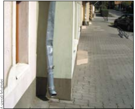
Összelapított csatorna a piacon
