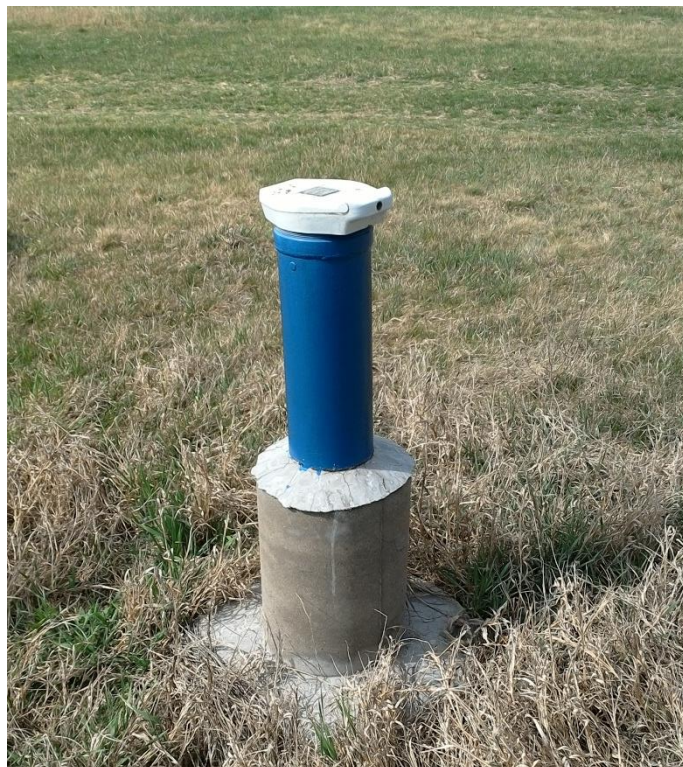
12. ábra: Jellemző kútfejkialakítás a monitoring kutak esetében
